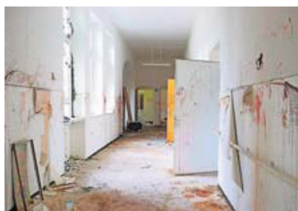
Die Flure des alten Klinikums sind heute verwahrlost und zum Teil verwüstet.
